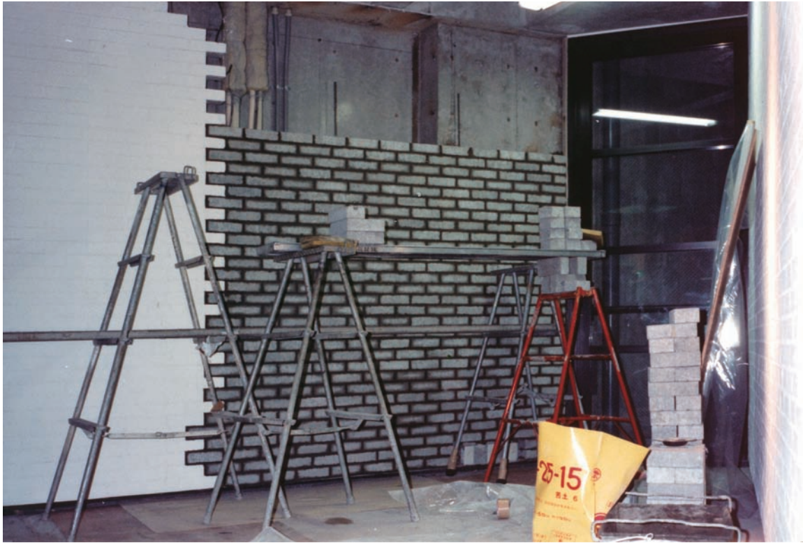
工事中のワタリウム美術館 2階展示室。特注のコンクリート・ブロックを積み上げて、内装を制作中の様子。1990年春ごろ。
